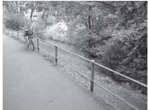
Hier ist dringende Abhilfe gefordert. Die große Gefahrenstelle entlang der Prinz-Georg-Straße.
